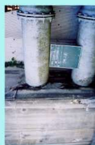
宮浦清水場 急速ろ過池破損（クラック）
