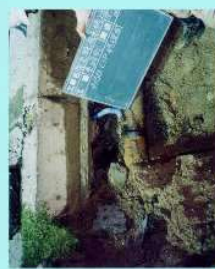
鋼鉄管φ150耗折れ破損 糸崎町県道糸崎港線
