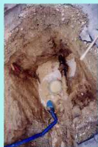
沼田西町 φ75耗鉄管 継手離脱
