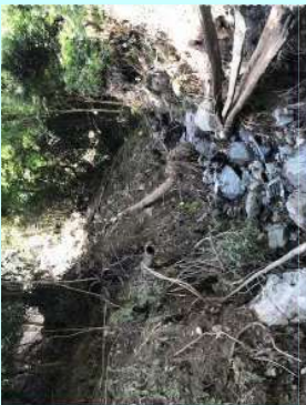
沖浦町の配水管の被災状況
