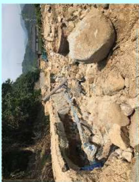
木原六丁目の配水管の被災状況
