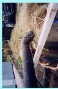
沼田東町釜山 鋼管φ200耗継手（溶接箇所）破損
