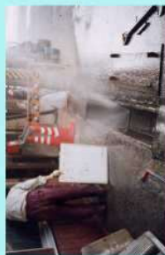
宮沖三丁目 φ13耗鋼管 給水管破損
