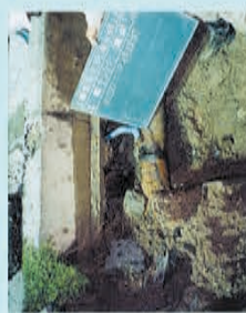
鉋鉋管φ150耗鋼折れ破損 糸崎町県道糸崎老線
