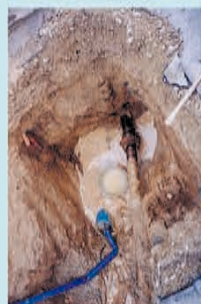
沼田西町 φ75耗鋼鉄管 継手離脱
