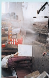
宮中三丁目 φ13鋼管 給水管破損
