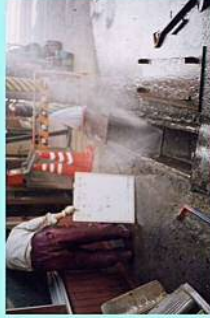
宮沖三丁目 φ13耗鋼管 給水管破損
