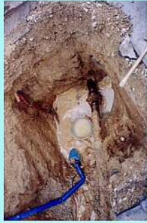
沼田西町 φ75耗鋼鉄管 継手離脱
