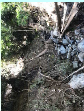
沖浦町の配水管の被災状況
