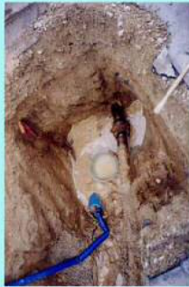
沼田西町 φ200耗鋼鉄管 継手離脱
