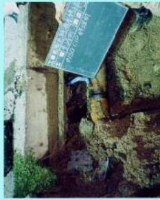
鋼鉄管φ150耗鋼折れ破損 糸崎町県道糸崎港線
