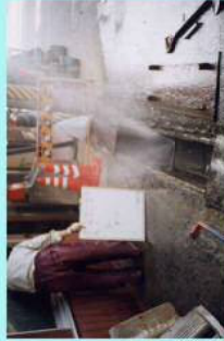
宮沖三丁目 φ13耗鋼管 給水管破損
