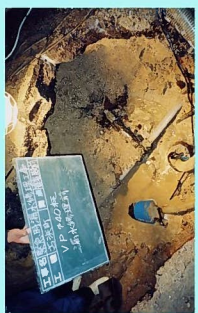
古浜町 φ40 継手ニール管 給水管破損
