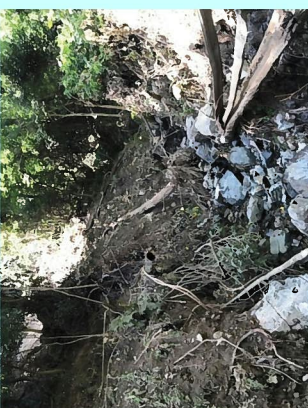
沖浦町の配水管の被災状況
