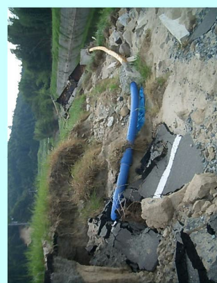
神田橋落橋に伴う水道管破損状況
