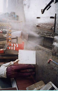
宮沖三丁目 φ13 鋼管 給水管破損
