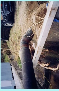
沼田東町金山 鋼管φ200 継手（溶接箇所）破損
