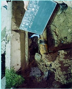
沼田西町 φ75 継手離脱 糸崎町県道糸崎港線 鋼管φ150 継手折れ破損
